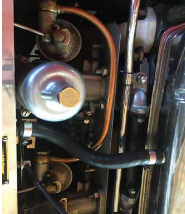
POVEZAVNA BAKRENA CEV ZA DOVOD GORIVA JE DVIGNJENA NAD UPLINJAČA IN ZAŠČITENA S PREGRADO, KI OBENEM UPOČASNI TUDI SEGREVANJE UPLINJAČEV.
